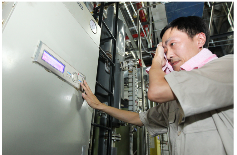
锅炉房内的室温已超过 50 度，总务处工作人员不畏炎热，严密监视，不敢有丝毫懈怠
