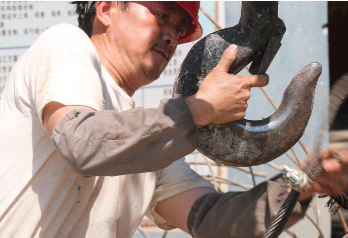
新门诊楼的建设正紧锣密鼓进行，基建处在确保安全质量、规范的前提下，攻坚克难，加快工程进度
